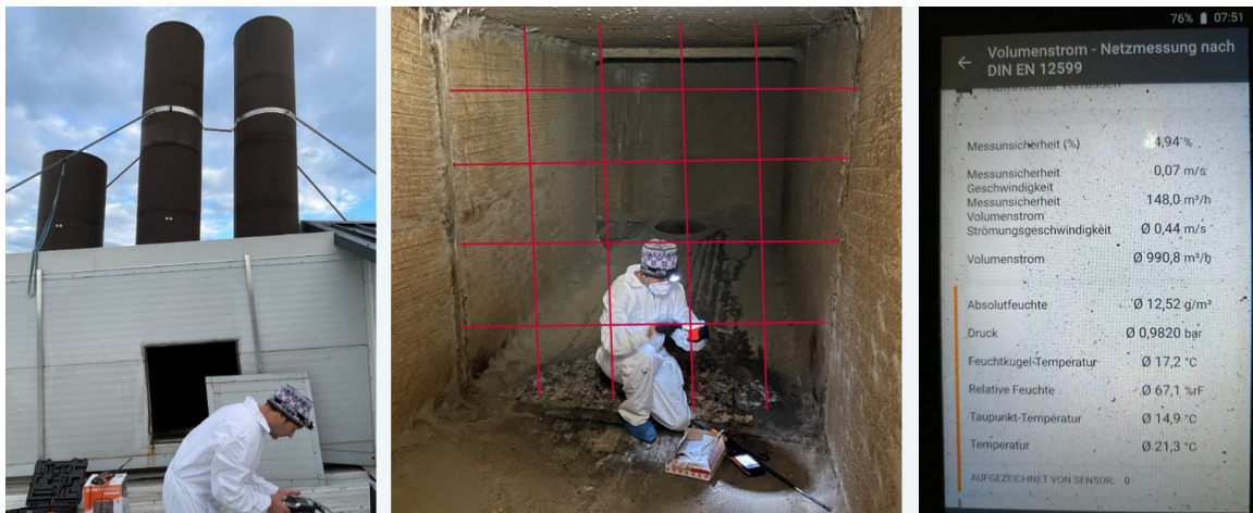
Abb. 2: Schweinebetrieb: Zugang zentrale Ablufteinheit (links), skizzierte Rastermessung in Abluftschacht (Mitte) und Display testo 400 (rechts) (Volumenstrom-Netzmessung nach DIN/ÖNORM EN 12599) (© M. Kropsch)
