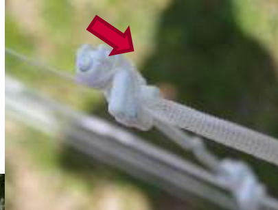
Falsche Montage Litzen brennen durch
