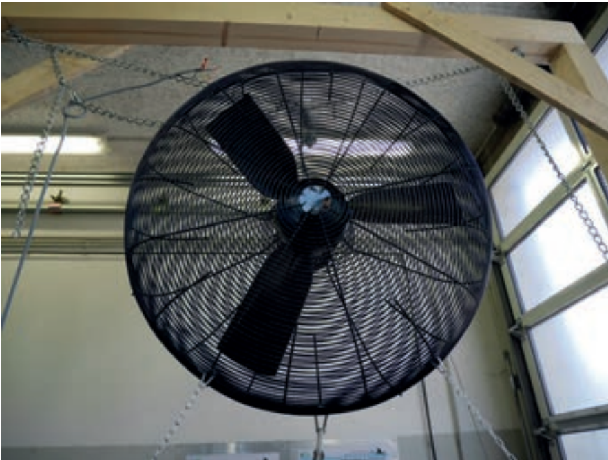
Ventilatoren müssen mindestens Luftgeschwindigkeiten von 2 m/s erreichen, um bei den Tieren einen Abkühlereffekt zu erzeugen.
