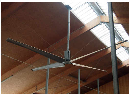
Ein Deckenventilator in einem Milchviehstall.
