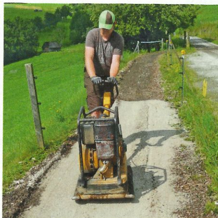
Sand-Schottergemische mit unterschiedlicher Körnung werden auf einem Schotteruntergrund bombiert aufgebracht, gut angefeuchtet und dann mit Walzen stark verdichtet.
