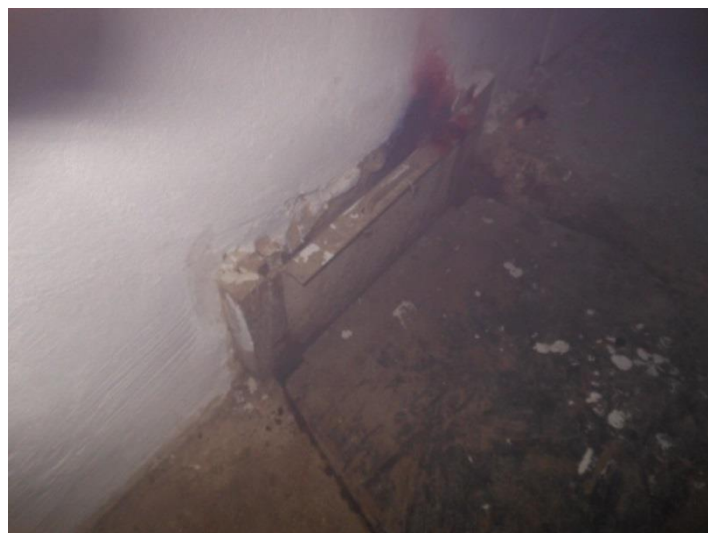
Abbildung 85: Falschlufteintrag über Schieber im Gangbereich
