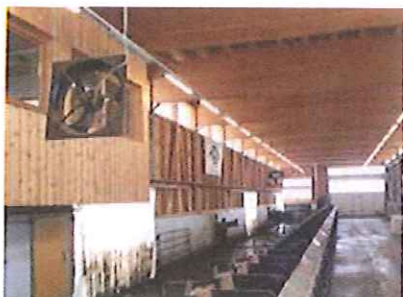
Die Montage über den Fressgittern bringt einen guten Kühleffekt.
