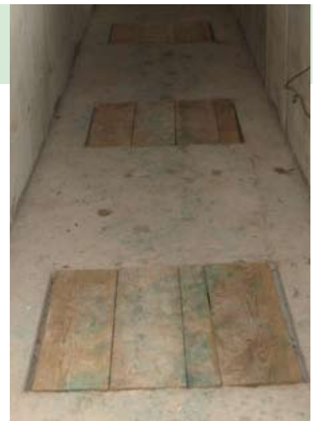
Diese Holzabdeckung ist unzureichend. Schadstoffbelastete Luft gelangt so über die Gülleoberfläche zu den Tieren.
