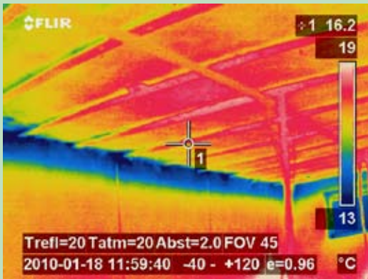
Bei dieser Porendecke zeigt sich ein 10 mm breiter Schlitz zur gedämmten Wand. Die Thermoaufnahme zeigt die Falschluf.
