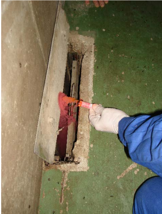
Bild 2: Nebelpatrone verdeutlicht die Falschluftransaugung
