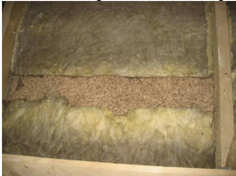
Bild 7: Fehlende Dämmung verursacht punktuellen Lufteintrag
