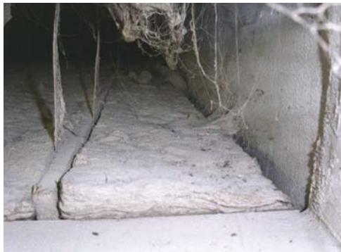
Bild 11: T- Träger in Ordnung aber keine Randpressung der Dämmung
