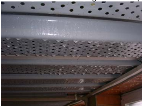
Bild 8: Kondenswasser ist Indikator für Mängel an der Dämmung
