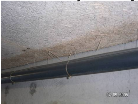
Bild 5: Verfärbungen an der Holzwolleplatte deutet auf Kaltlufteintrag hin
