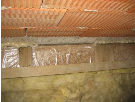
Bild 3: Dämmung zur Wand fehlt
