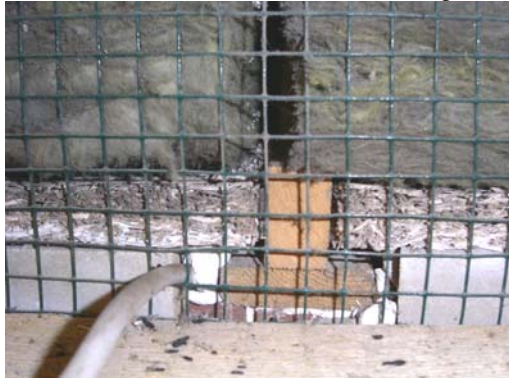
Bild 10: Blick in den Zwischenraum verdeutlicht die Ursache
