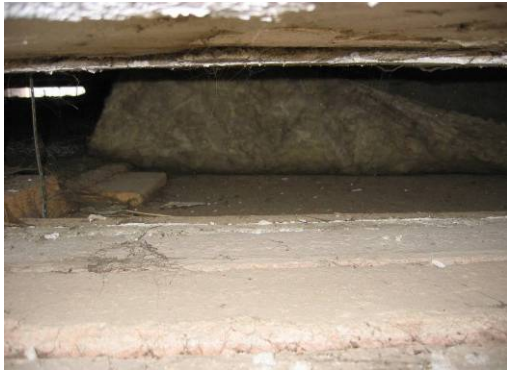
Bild 6: Dämmung im Zuluftbereich abgehoben
