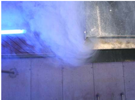
Bild 1: Luftkurzschlüsse an Abluftschächten
